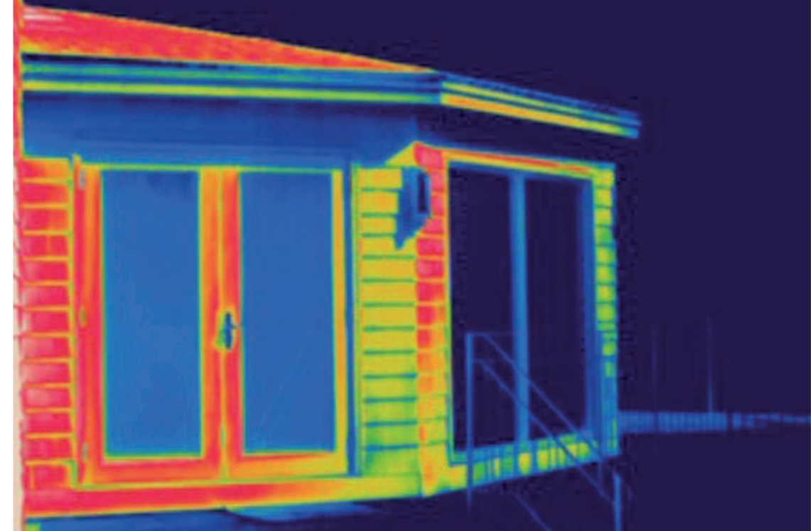
Wärmebildansicht von den Wärmeverluststellen eines ungedämmten Hauses.
