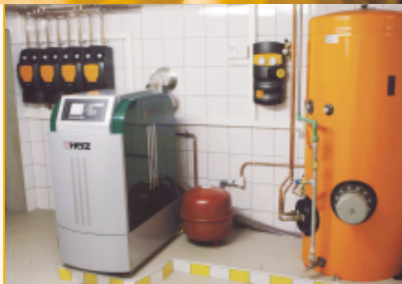
Abb. 6: Diese vollautomatische und geregelte Pellet-Zentralheizung mit 13 kW versorgt ein Einfamilienhaus. Die Holzpellets werden über eine flexible Austragungsschnecke aus nebenliegendem Pellet-Lagerraum zugeführt. Solaranlage und Pufferspeicher unterstützen die Pelletheizung. Bild: Hans-Jürgen Helbig GmbH, Nörten-Hardenberg
